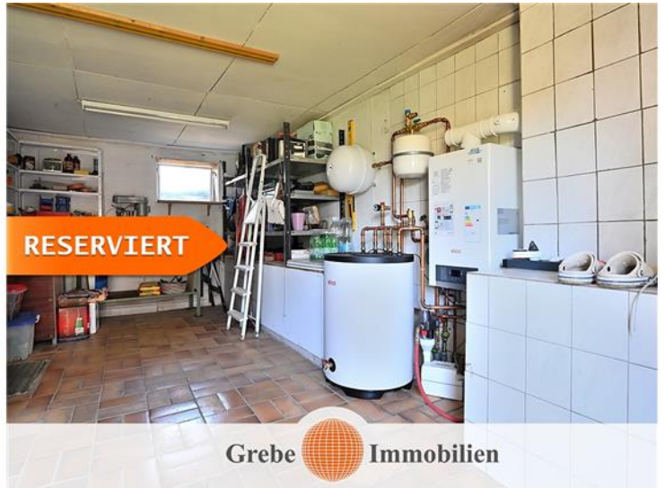
Heizraum neben der Bauernstube
